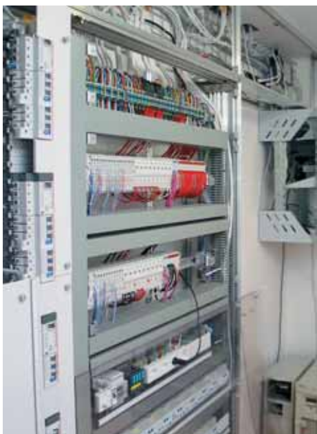
Alles kompakt zusammen: Elektroverteilung, Kommunikations-Rack, Server, Multiswitch und anderes mehr.
