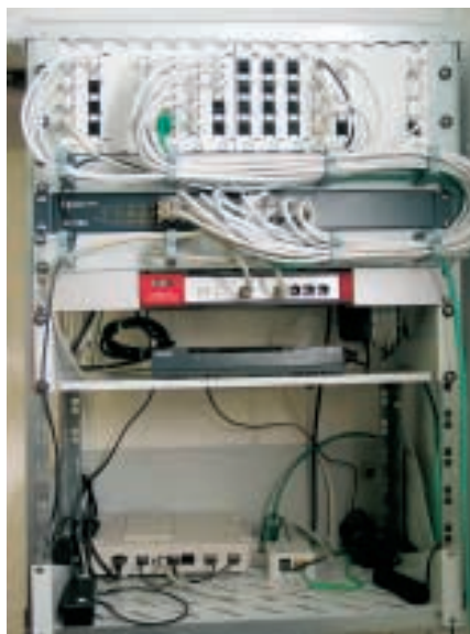
Ein kleines 19-Zoll-Rack als Kommunikationszentrale.
