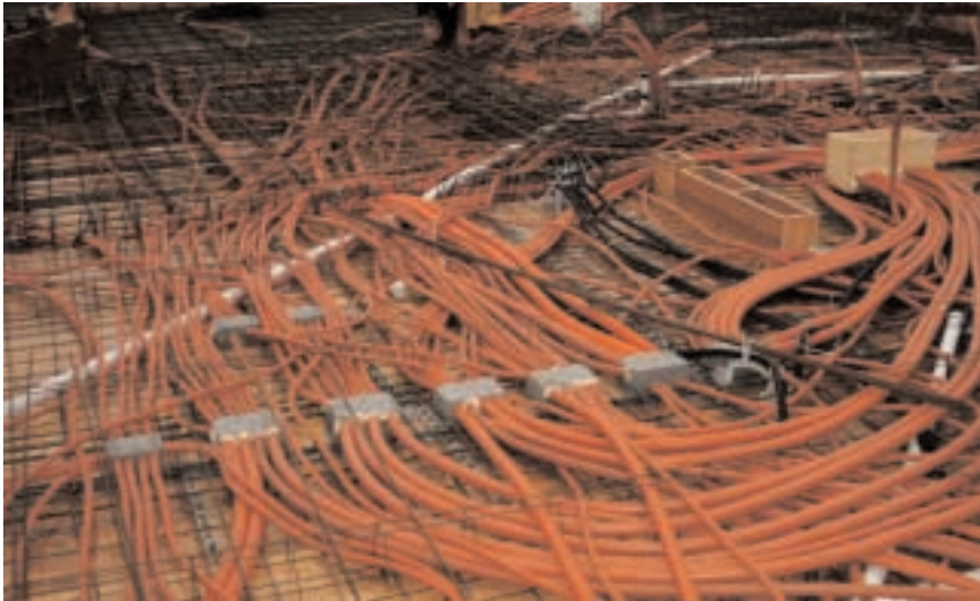
«Kann man diese Decke noch betonieren?», dürfte sich wohl jeder Bauingenieur fragen.
